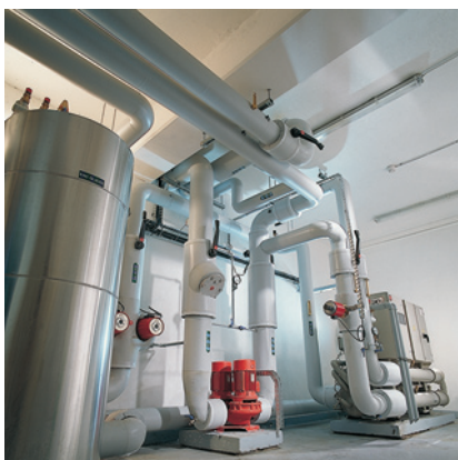
Application de pompage
